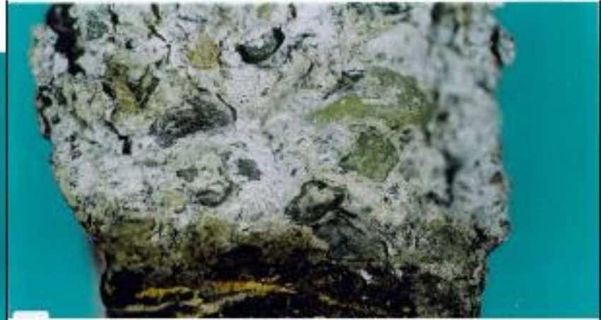
Figur 2: Anaeroba forholdene ved 10-20 ppm H 2 S i luft. Korrosjons skadoma etter 17 månader er omkring 10 mm. Den grå/gula massen er gips.
